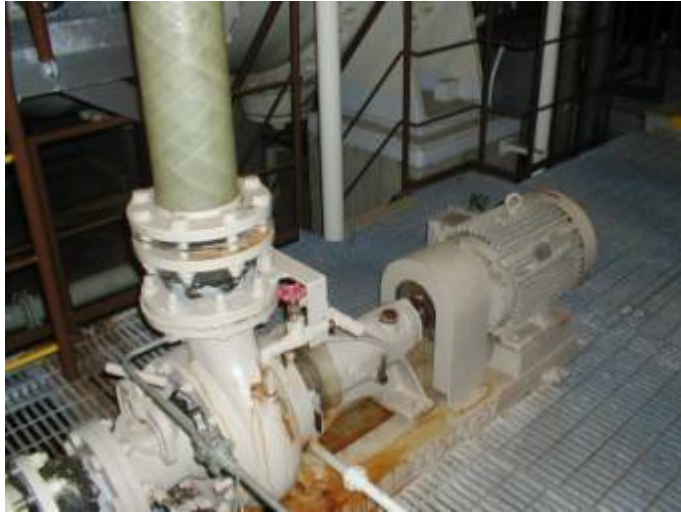
循環ポンプ外観
