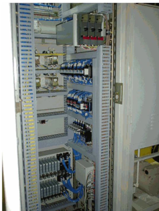
水素ガス制御盤 (内部)
