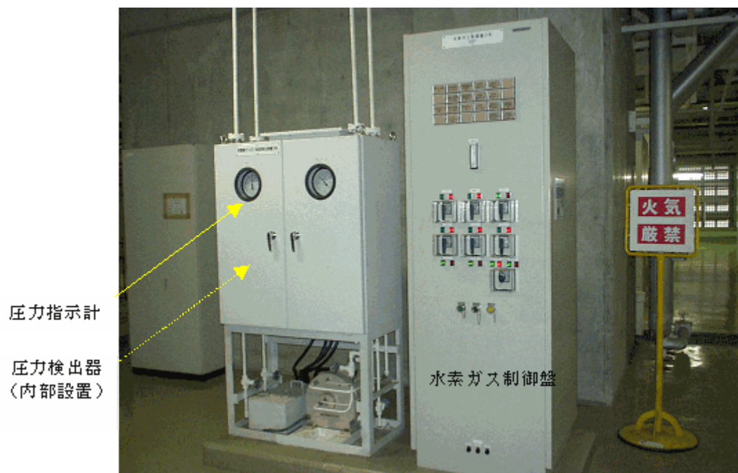
水素ガス制御盤等
