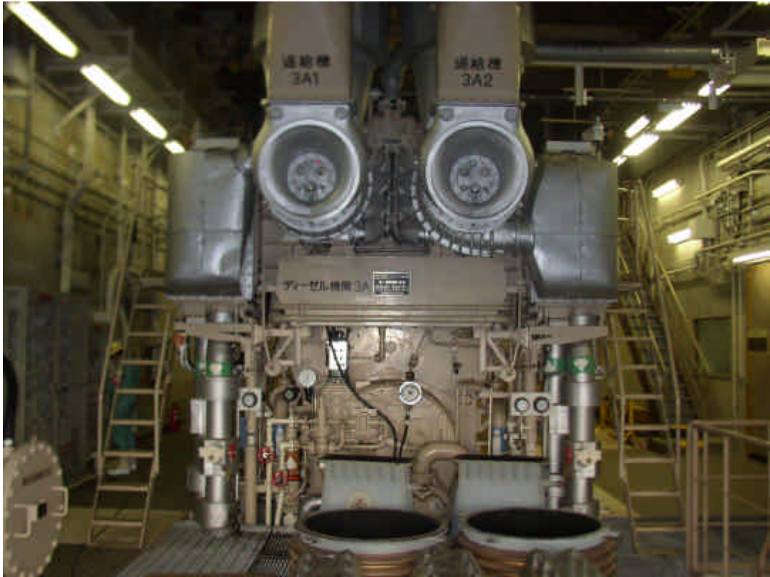
非常用ディーゼル発電機全景
