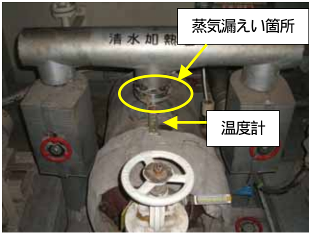
非常用ディーゼル発電機清水加熱器
