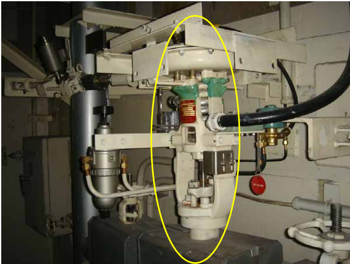
安全補機開閉器室空調ユニット2 A ヒータ制御弁
