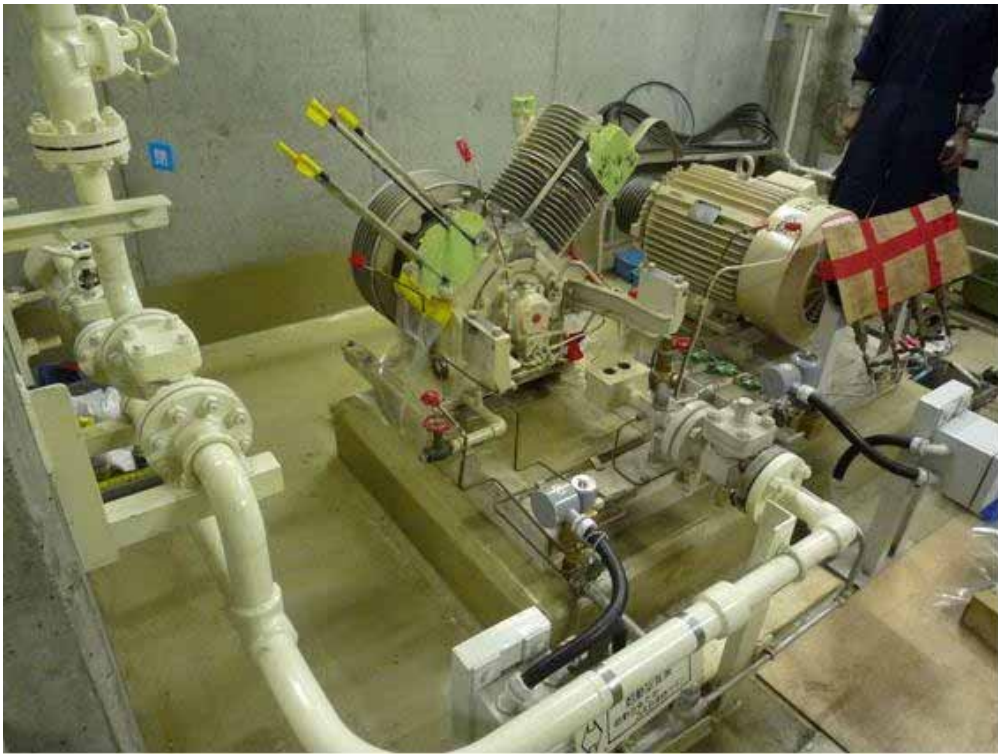
始動用空気圧縮機 分解状況
