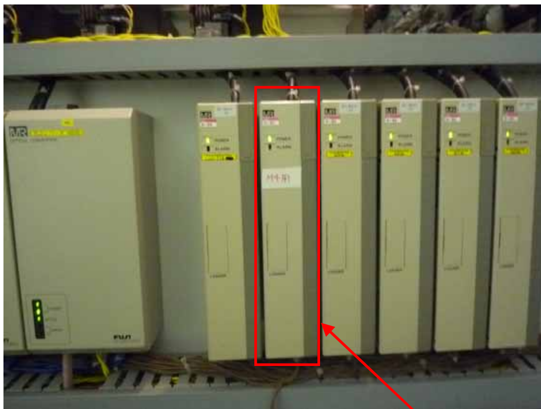
環境モニタリング盤内（伝送装置）
