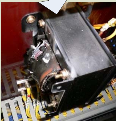
制御用変圧器(拡大)
