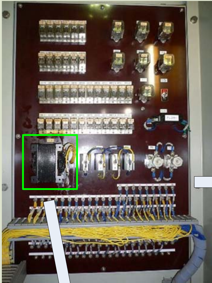
電源装置交換前
