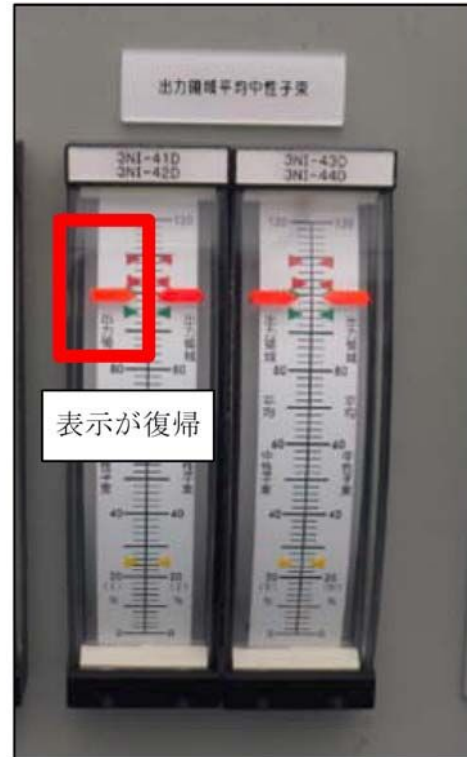
指示計 (中央制御盤)
