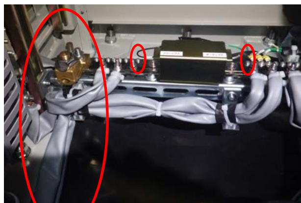
改修後の接地回路
