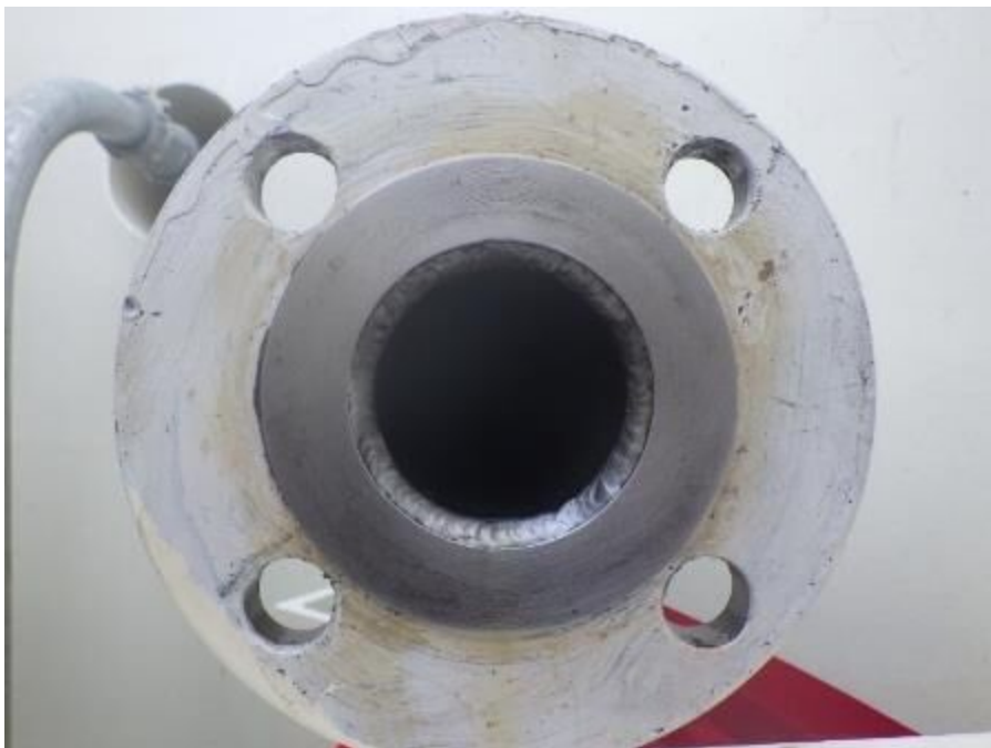
(下流側：出口電動弁側フランジ)
