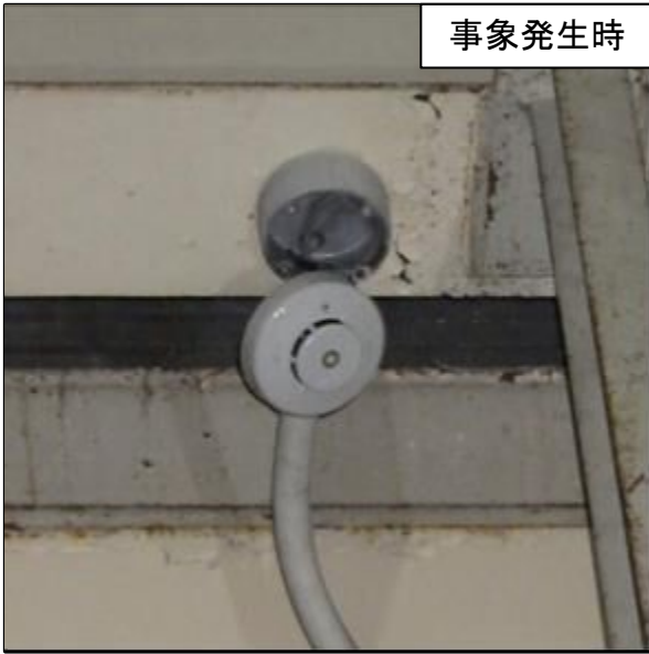
火災感知器の台座が外れた状態
