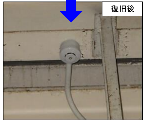
火災感知器を取り付けた状態
