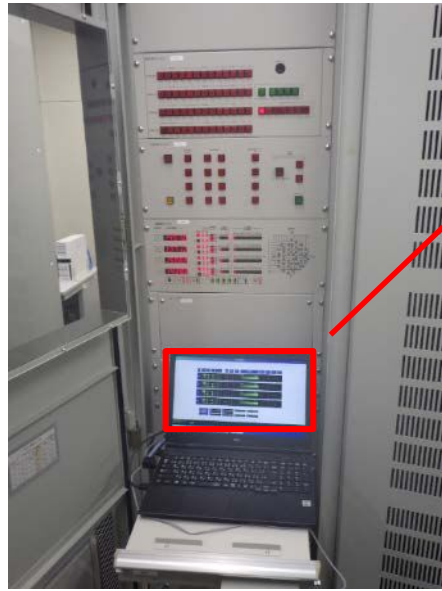
炉内計装盤内部
